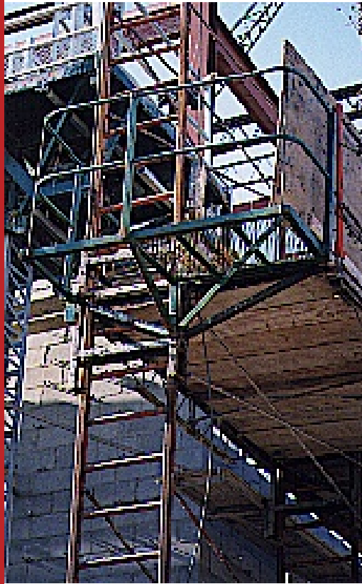
Plataforma de escalera
